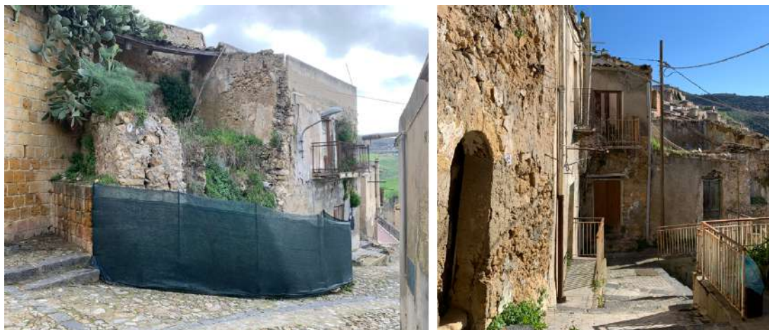
Fig. 3.40. Esempi di effetto contagio. A sinistra: crollo esteso della facciata con conseguente compromissione del cantonale inglobato. A destra: crolli estesi delle coperture in seguito a indebolimento del muro portante condiviso.
