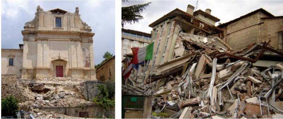
Figura 26 Effetti del terremoto del 2009; crollo del timpano di facciata della chiesa della madonna dei Raccomandati a San Demetrio de' Vestini (sx); crollo totale dell'Hotel Duca degli Abruzzi a L'Aquila (dx).
