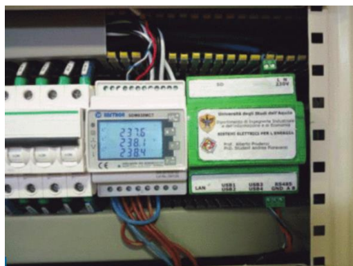
Fig. 74 Dispositivo di supervisione installati nel quadro elettrico del laboratorio Edison dell'Università degli Studi dell'aquila.
