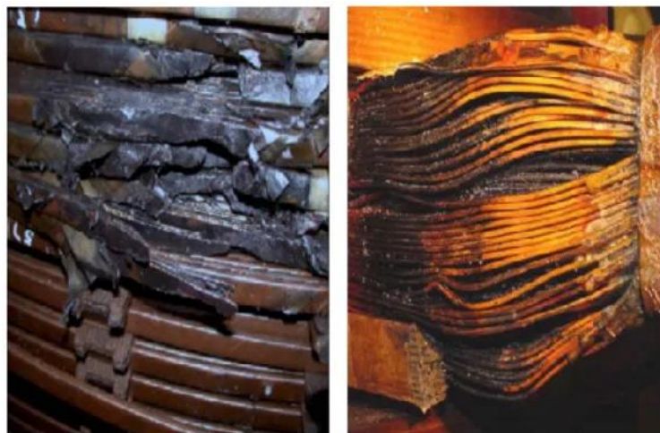
Fig.20 Trasformatori della rete di distribuzione elettrica del Sud Africa, danneggiati a seguito della tempesta magnetica dell'Ottobre 2003
