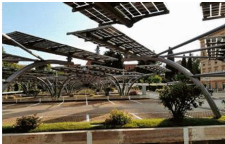
Fig. 46 Impianto fotovoltaico costruito sul parcheggio dell'Addolorata.
