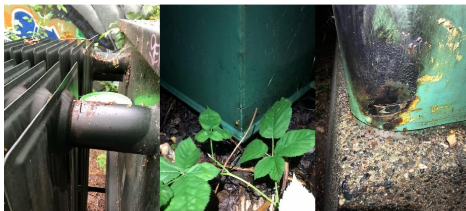
Fig.9 Atti di vandalismo (tagli) su trasformatori in olio [13]
