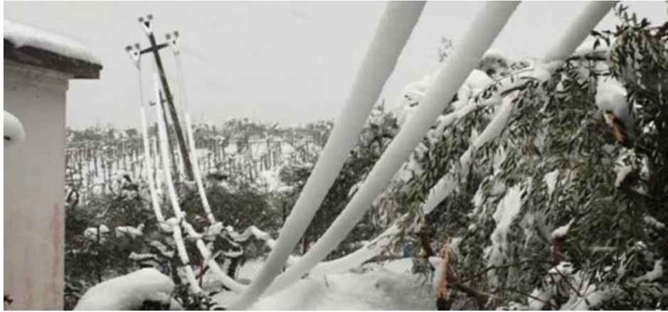
Fig.14 Linea MT caduta per sovraccarico neve nell'evento del 17/01/2017. Fonte: Rete8 Abruzzo
