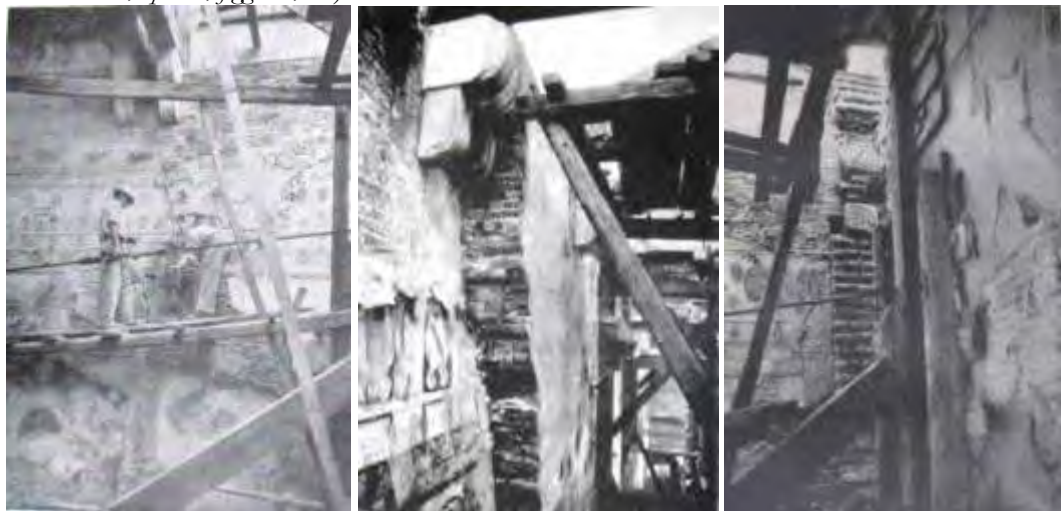
A sinistra: dettaglio di un tenditore del muro settentrionale. Al centro: dettaglio del muro est in cui è stato rimesso a piombo il primo tratto (a destra della foto) mentre quello adiacente è ancora nella posizione deformata (a sinistra nella foto). A destra: dettaglio che evidenzia il distacco del muro settentrionale da quello occidentale. (in F. FORLATI, op. cit., figg. 49, 42, 44).
