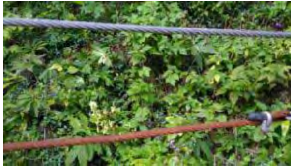
Foto di cavi in acciaio esposti all'aperto. Sotto: un cavo ossidato dopo alcuni anni dalla posa; Sopra: un cavo recentemente installato.
