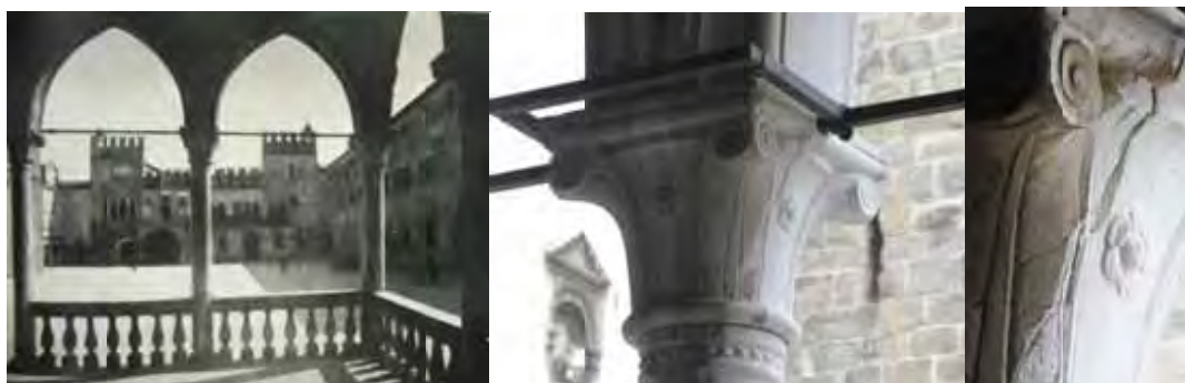
Capodistria (Slovenia), Loggia. A sinistra foto storica della loggia dopo il restauro. Al centro e a destra: foto recente di un capitello lesionato e consolidato con un nucleo portante interno negli anni trenta. Il dettaglio mostra la lesione ancora oggi visibile.
