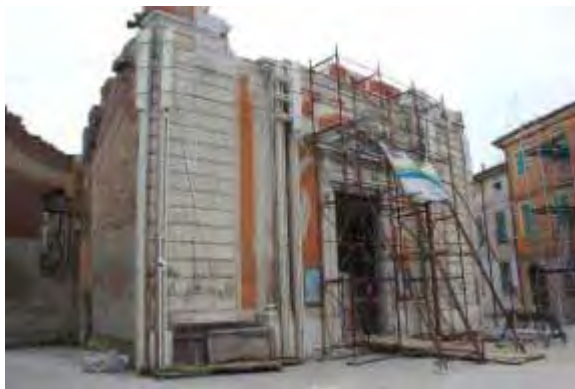
San Felice sul Panaro (MO), chiesa di San Felice Vescovo. Facciata dopo il crollo della parte superiore a seguito del sisma del 2012. Si possono vedere le opere provvisorie atte a contrastare un eventuale ribaltamento della facciata, scollegata dalle murature longitudinali. Una prima ipotesi di progetto ne prevedeva la stabilizzazione mediante cavi post-tesi esterni alla muratura, ancorati a piastre metalliche in sommità del muro e alla fondazione.
