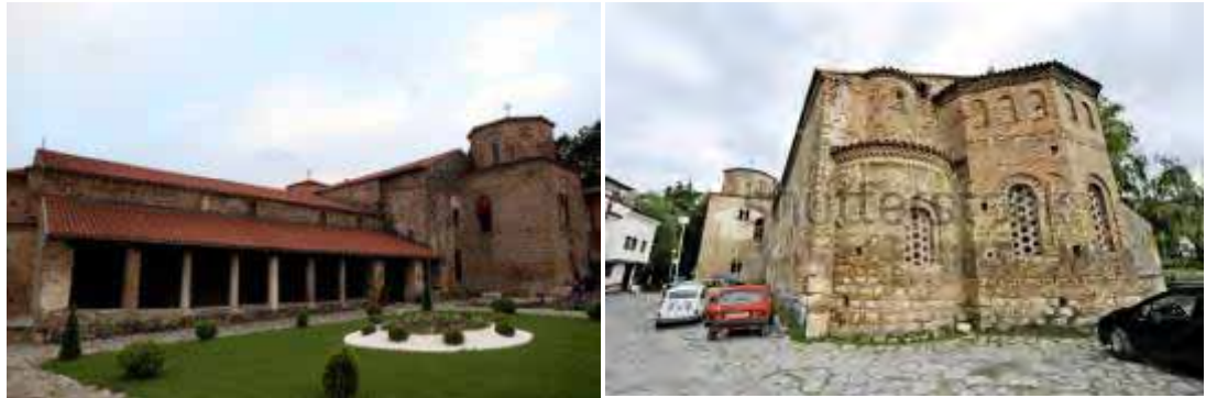
Veduta generale della chiesa di S. Sofia: a sinistra il prospetto nord; a destra le absidi e il muro meridionale privo dei contrafforti murari. Alla base dei muri si possono notare i segni dell'umidità di risalita.
