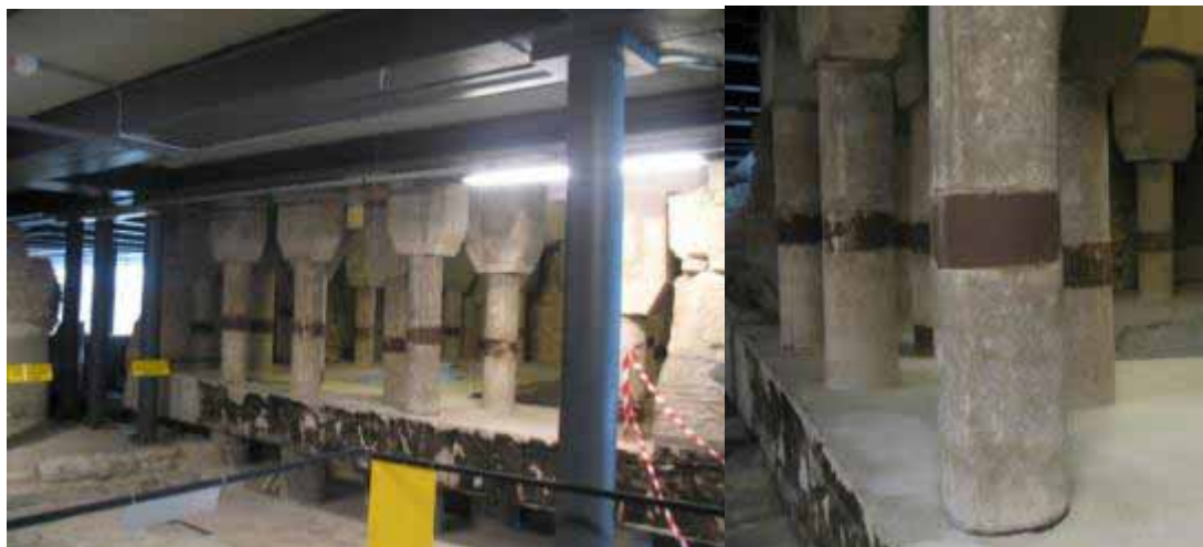
Concordia Sagittaria, campanile. Veduta delle sottofondazioni. La parte emergente dei pali fu rivestita con rete e conglomerato per aumentarne il diametro pochi anni dopo la loro realizzazione, a seguito all'approfondimento dello scavo nelle aree limitrofe. Il cordolo inferiore di colore nero fu aggiunto per ridurne la snellezza. A destra: dettaglio della superficie di un palo in conglomerato cementizio: si può notare l'ossidazione dell'anello esterno nella giunzione tra gli elementi prefabbricati e l'alterazione della superficie del conglomerato.
