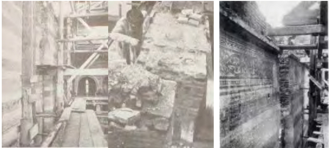
Nelle foto realizzate durante i lavori si può notare la diversa posizione dei lembi di una lesione che separa un primo tratto di muro raddrizzato e quello adiacente ancora fuoripiombo. (in F. FORLATI, op. cit.)
