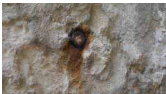
Dettaglio di un tubo metallico inserito nella muratura per le iniezioni cementizie, poi lasciato in situ e tagliato per la parte sporgente. Su può notare l'ossidazione del metallo e la macchia sul paramento.
