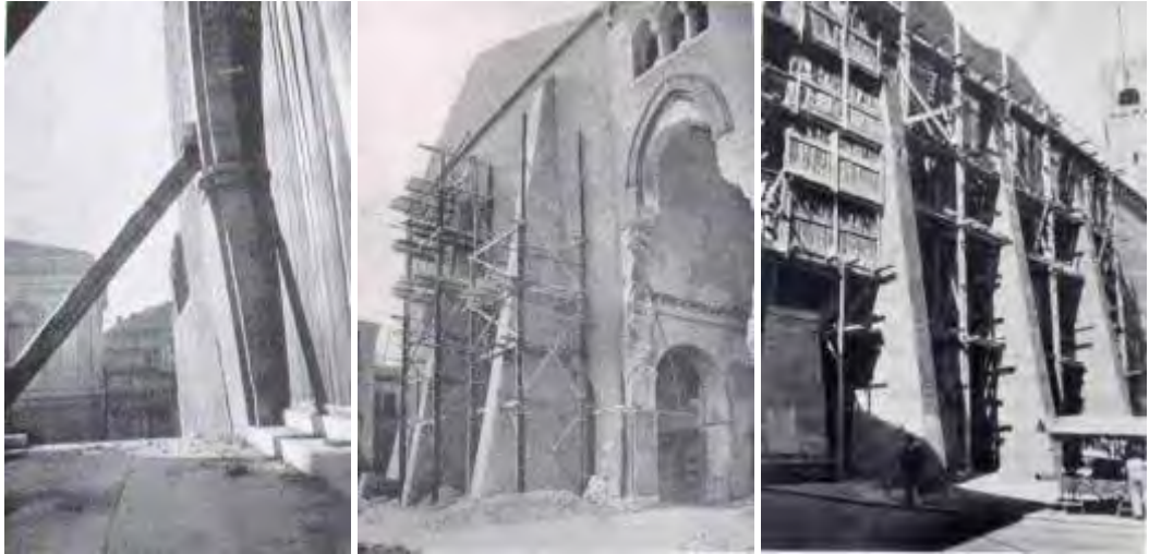
Foto che documentano il fuoripiombo delle murature perimetrali e le opere di presidio. A sinistra: il muro verso lo scalone esterno. Al centro e a destra: la facciata nord con le opere provvisorie di sostegno. (in F. FORLATI, op. cit., figg. 37, 40 e C. PEROGALLI, op. cit.).
