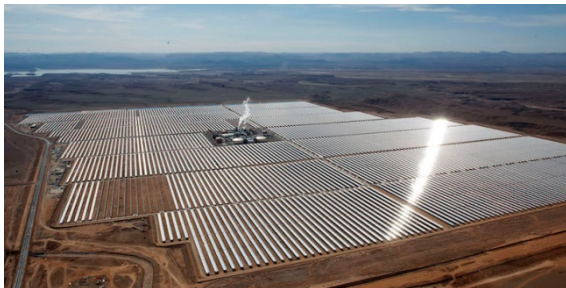
Centrale fotovoltaica Noor 1 , Ouarzazate, Marocco, 2016 – Vista dell'impianto
