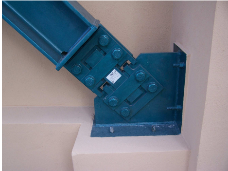
Figura 1.14: Scuola Media Busciolano (PZ), particolare del dissipatore utilizzato.
