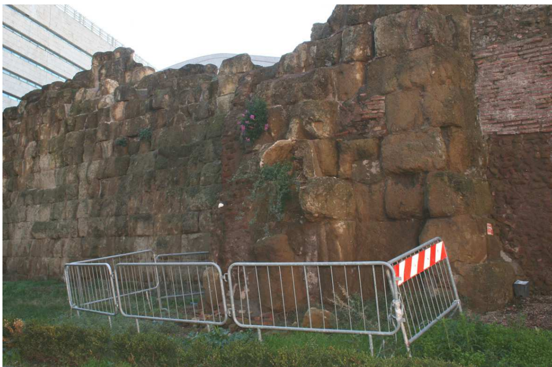
Figura 55 Recinzione temporanea per distacco di materiale tufaceo (foto M. Dante 2011).
