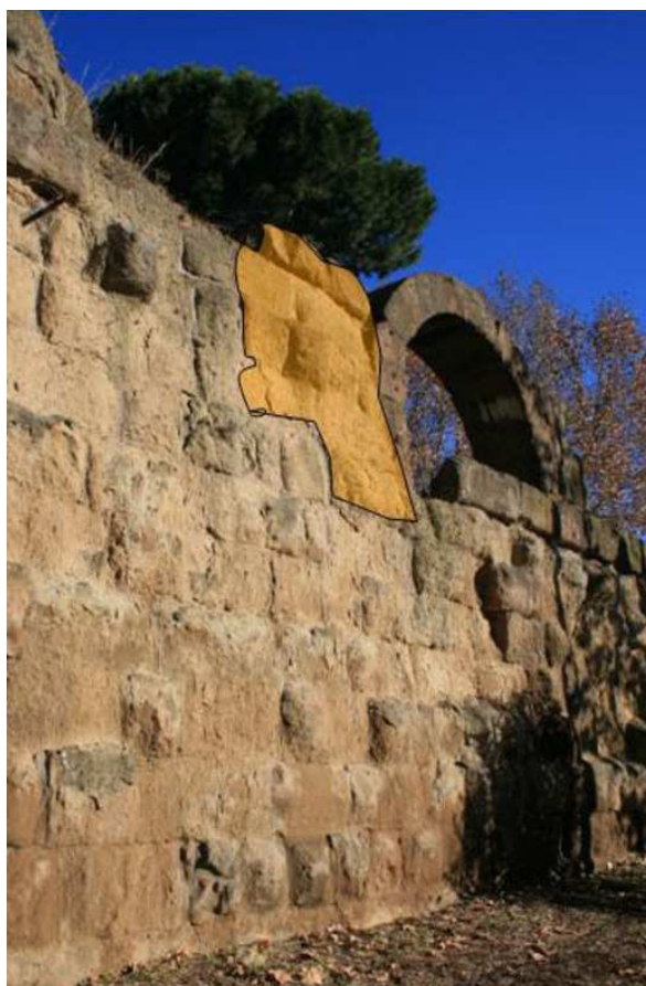
Figura 62 Mura “serviane” in viale M. Gelsomino: in evidenza l’area interessata da una sperimentazione di prodotti consolidanti nel 1987 (elaborazione M. Dante).
