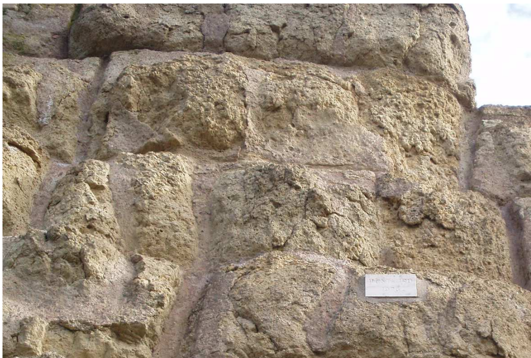
Figura 53 Manifestazione di degrado: de coesione, corrosione ed erosione (foto M. Dante).
