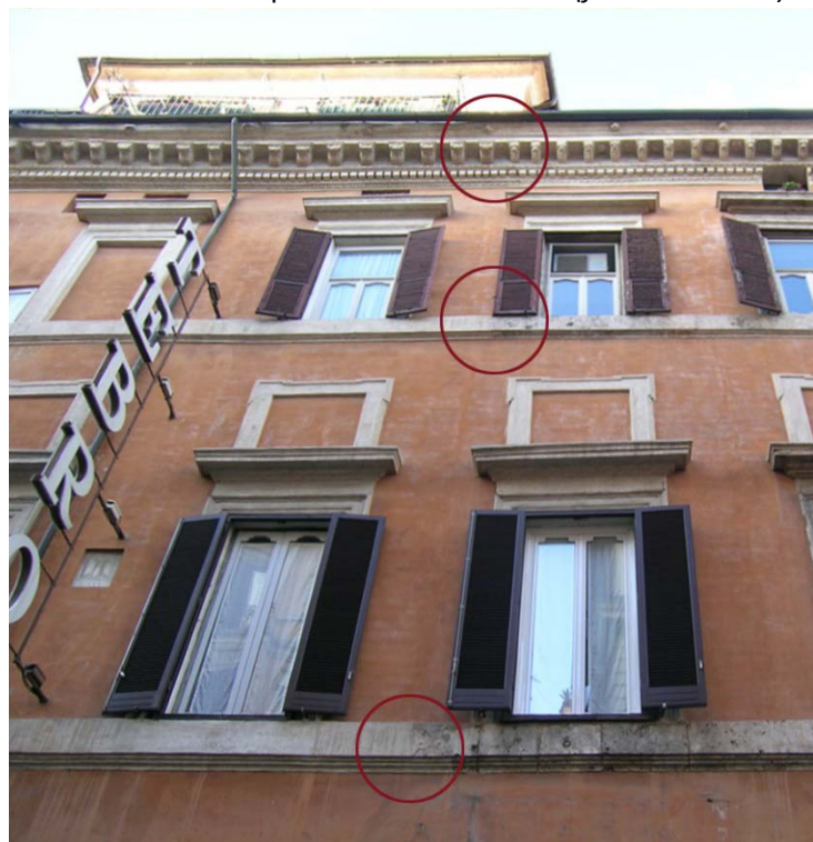
89. Roma, Palazzo Pallavicini, prospetto su via dei Prefetti, dettaglio. Sono evidenziate le discontinuità presenti nelle fasce marcadavanzale e nel cornicione in corrispondenza della giunzione tra palazzo cinquecentesco e ampliamento seicentesco (foto M. Peretti)
