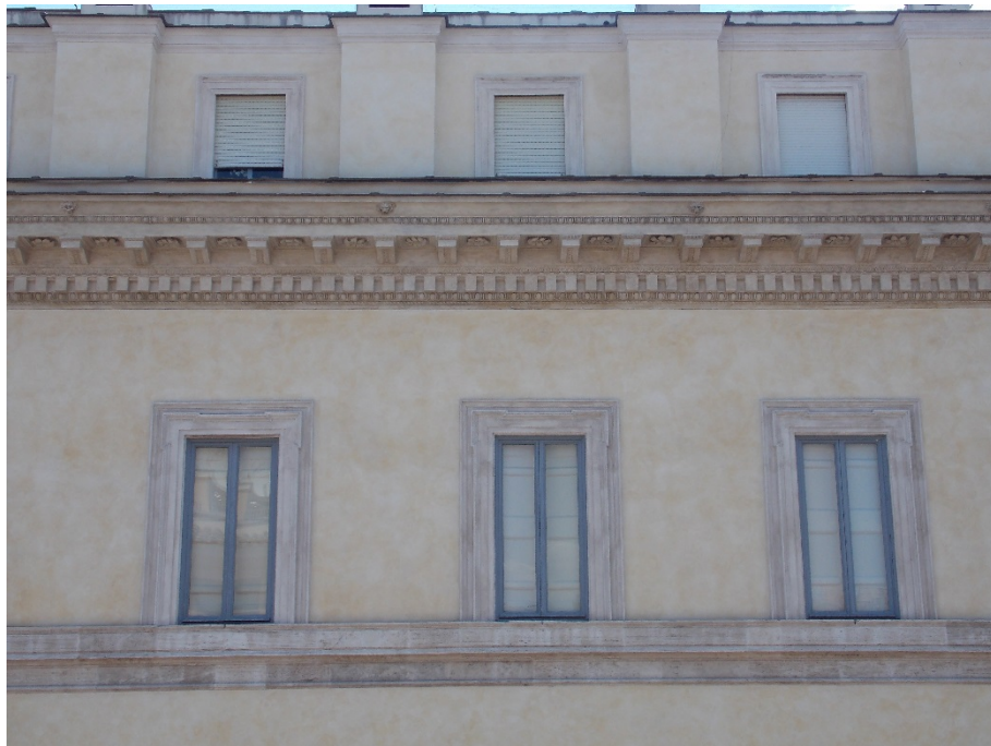
31. Roma, Palazzo Mattei-Caetani, c. 1540-1554. Finestre dell'ultimo piano e cornicione (foto M. Peretti)
