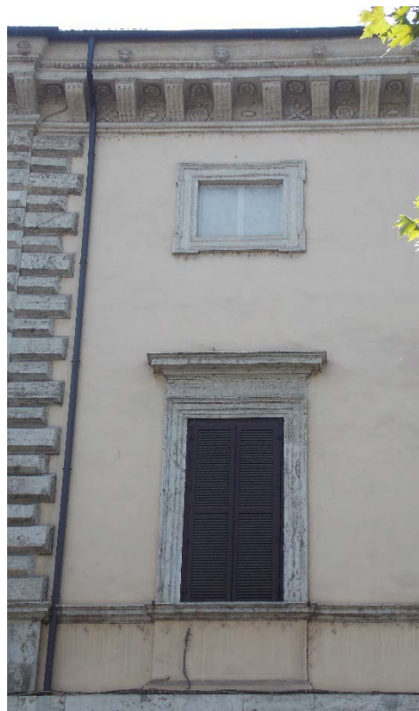
115. Roma, Palazzo Salviati, finestre del piano nobile e del mezzanino (foto M. Peretti)
