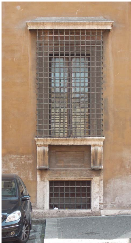
154. Roma, Palazzo del Commendatore. Finestra inginocchiata al piano terra (foto M. Peretti)
