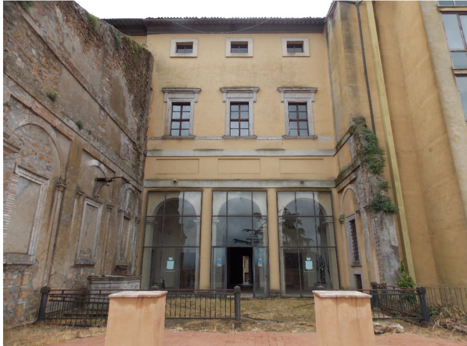
45a. Proceno, Palazzo Sforza, c. 1550-1554, c. 1559-1567. Controfacciata sul cortile (foto M. Peretti)
