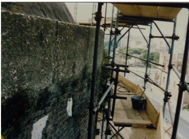
fig. 66 - Particolare del cordolo in c.a.; si nota il degrado dei ferri di armatura e la vegetazione sulla parte laterizia che è alimentata dalle acque meteoriche percolanti dalla semicalotta, Roma (ASSBAR, Basilica di Massenzio. Manutenzione straordinaria... , 1996)
