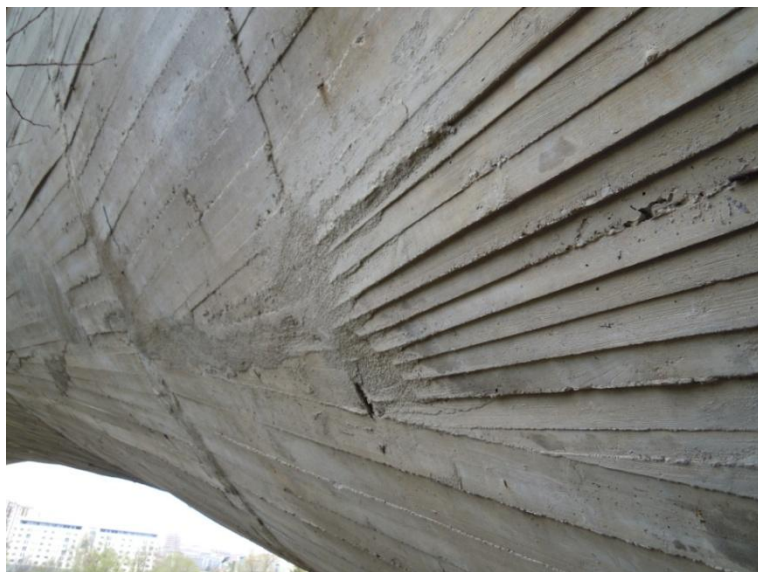
fig. 40 - Particolare dei segni delle tavole delle casseforme sull'intradosso della volta del ponte, Potenza (foto dell'A., 2015)
