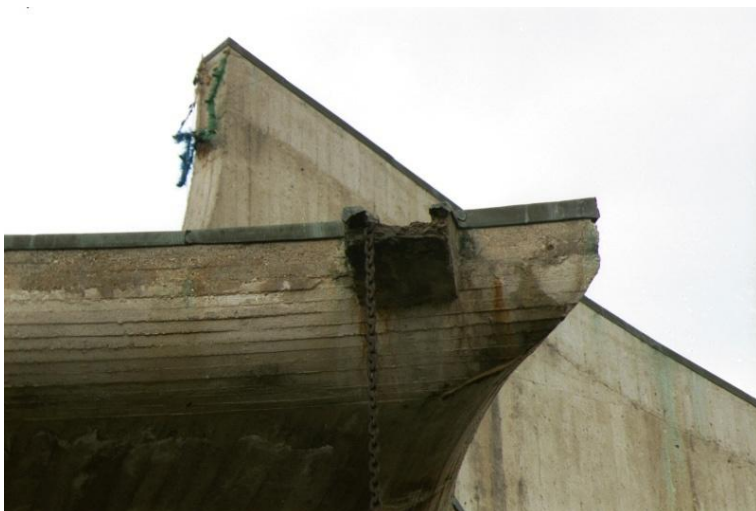
fig. 19 - Particolare del sistema di smaltimento delle acque meteoriche della chiesa prima dell'intervento, Sarteano (foto dell'arch. F. Bardelli, 1996)
