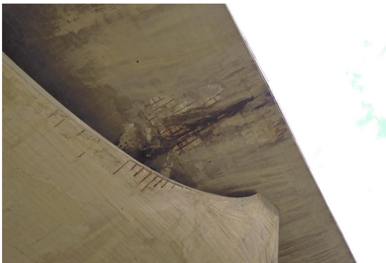
fig. 47 - Stato di alterazione e degrado del c.a. del ponte, Potenza (foto dell'A., 2015)
