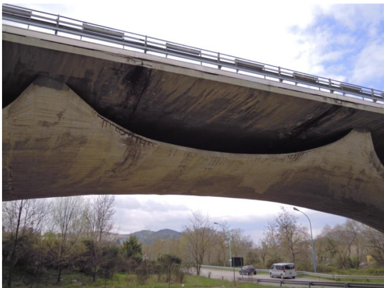
fig. 46 - Stato di alterazione e degrado del c.a. del ponte, Potenza (foto dell'A., 2015)
