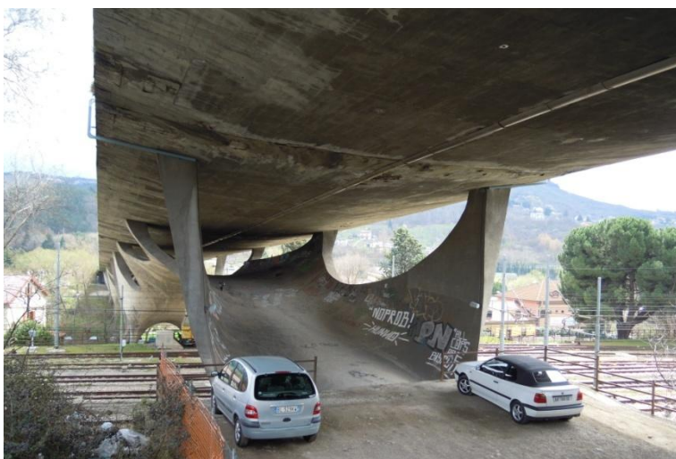
fig. 48 - Stato di alterazione e degrado del c.a. del ponte, Potenza (foto dell'A., 2015)
