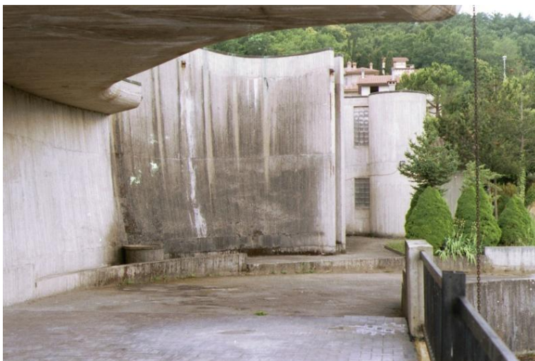
fig. 17 - Particolare di un setto in c.a. della chiesa prima dell'intervento, Sarteano (foto dell'arch. F. Bardelli, 1996)
