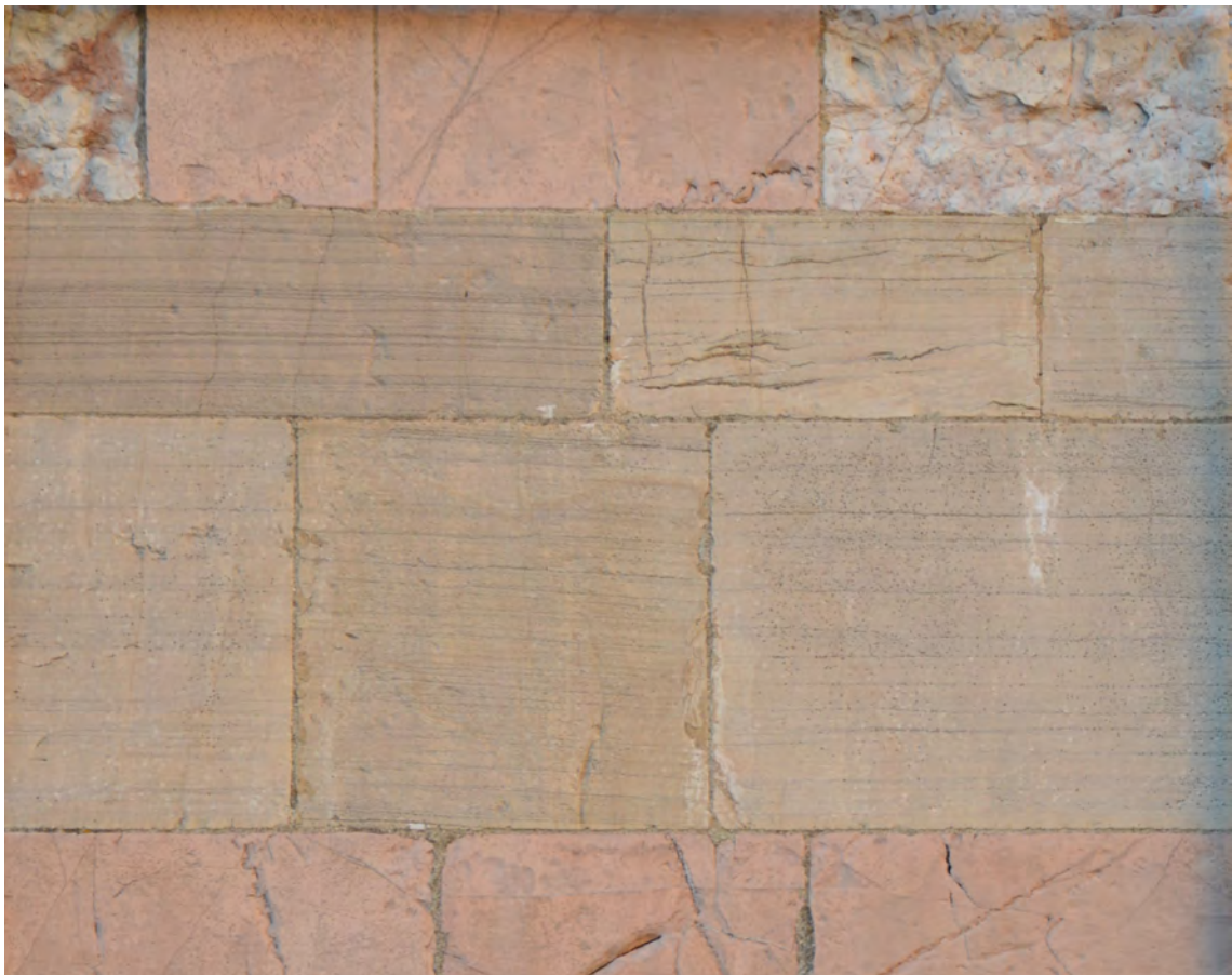
Fig. 105. Esempio di Pitting nei conci del paramento esterno della muratura del campanile del Duomo di Todi. Fotografia E. Scopinaro 2016.
