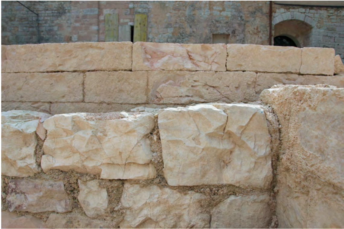
Fig. 104. Esempio di scagliatura nei conci della muratura esterna dell'avancorpo romanico della chiesa di S. Croce in Sassovivo. Fotografia E. Scopinaro 2016.
